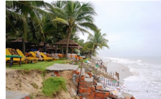
Sạt lở công trình du lịch tại bãi biển Cửa Đại 36
